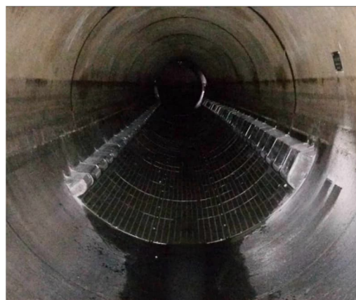
Abb. 32: Abwasserwärmetauscher im Kanal [UHRIG]
