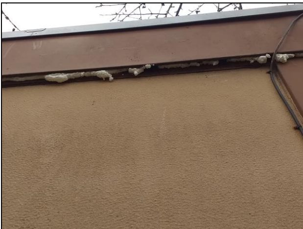
Mit Bauschaum verschlossene Spalten
