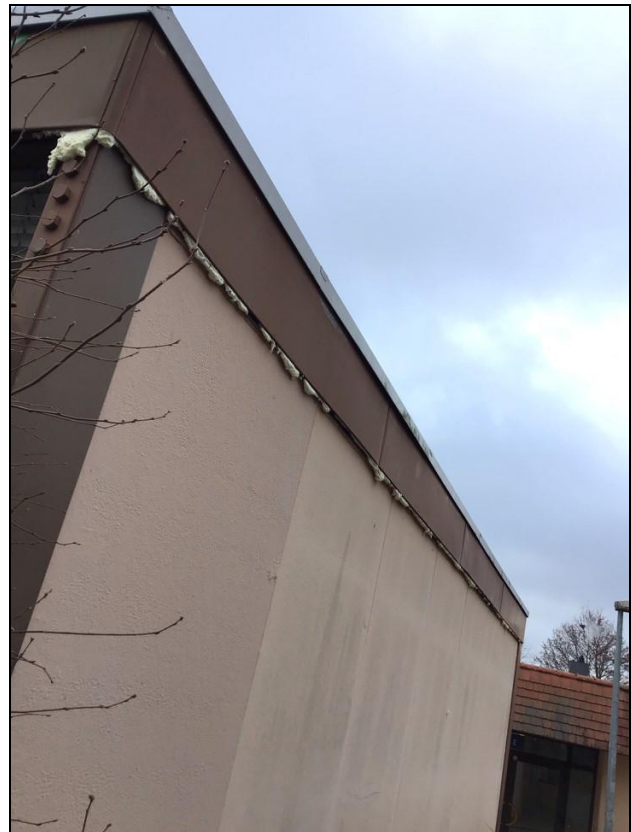
Mit Bauschaum verschlossene Spalten
