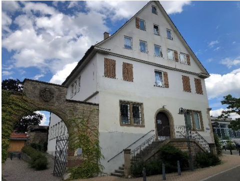
Erheblicher Mangel in der Bausubstanz Stiftstraße Quelle: BLU architekten
