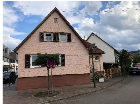
Mangel in der Bausubstanz Buhlstraße Quelle: BLU architekten
