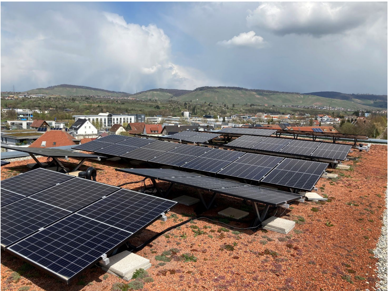
Photovoltaikanlage auf dem Dach der Energiezentrale im Junkeräcker 2
