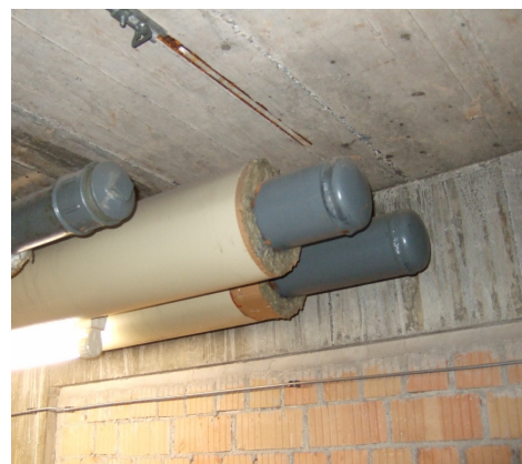
Heizkreis DN 125 für den Ausbau
