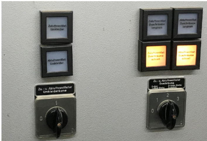
Bedienschalter Anlage Duschen und Umkleiden
