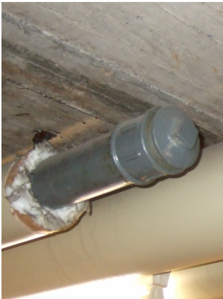
Rohrleitung für den Ausbau
