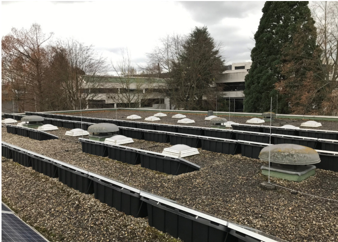
Lage Dachventilatoren Hallendach
