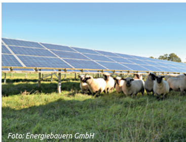
Foto: Energiebauern GmbH
