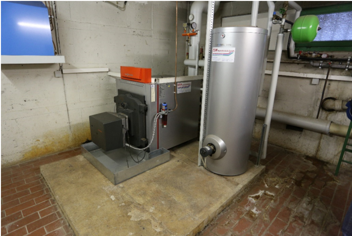
Abb. 4: Heizkessel Grundschule Schnait
