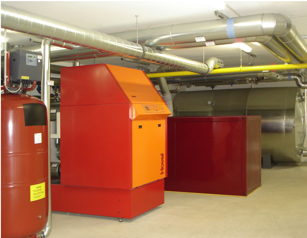
Abb. 25: Blockheizkraftwerk und Heizkessel
