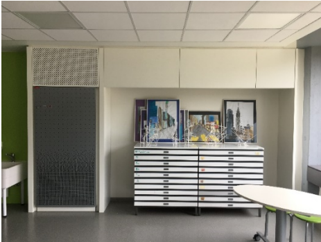
Beispiel (dezentral) Kocherburgschule Aalen Klassenraumgerät (Rosenberg) Typ Suprabox (keine Luftkühlung möglich)
