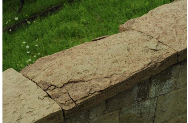
Abb. 13 Erhebliche Substanzverluste an Seiten und Draufsicht mit vertikalem Einriss Regenwasser versickert im Abdecker -> Gefahr der Frostsprengung und weiteren Zersetzung Beurteilung: Austausch anzuraten
