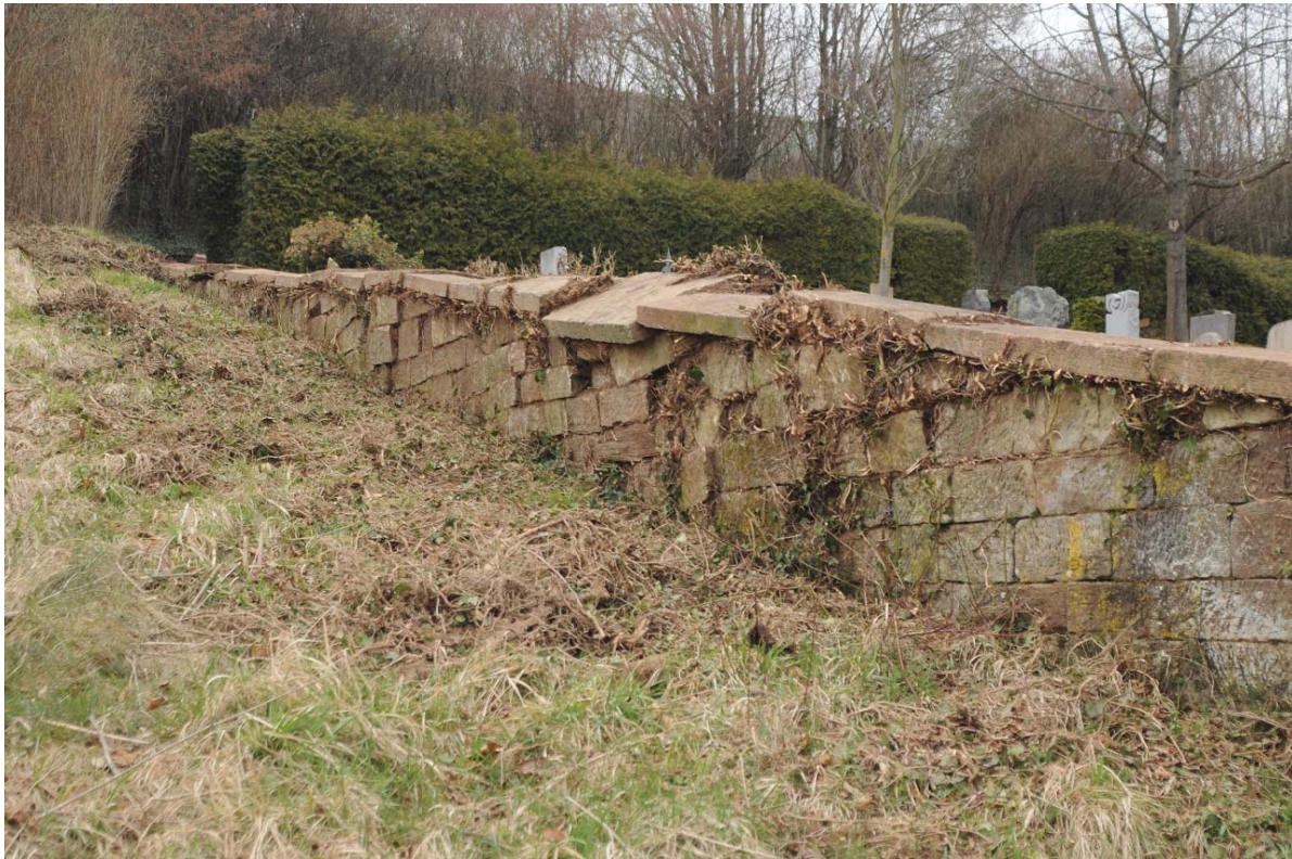
Abb. 06 oberer Abschnitt der Mauer mit aufgelöstem Mauerverband
