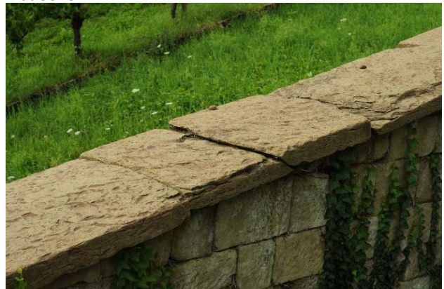
Abb. 17 Bruch des Abdeckers Beurteilung: Erhalt möglich, Klebung des Bruchs
