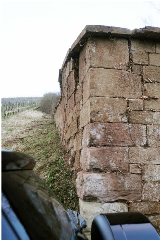
Abb. 04 südwestl. Ecke, vorgewölbtes Mauerwerk
