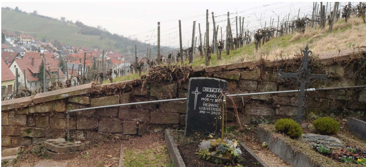
Abb. 07 oberer Mauerabschnitt innenseitig, durch Wurzeln herausgedrücktes Mauerwerk
