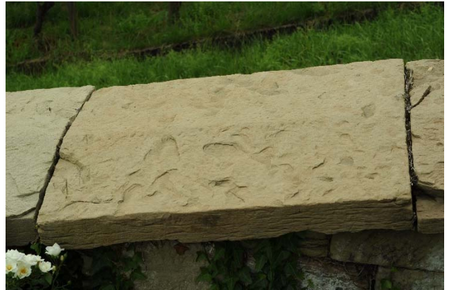
Abb. 11 flächige Verwitterung an Draufsicht mit zahlreichen flachen Abplatzungen
