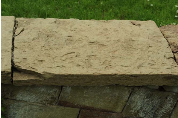
Abb. 12 flächige Verwitterung an Draufsicht mit zahlreichen flachen Abplatzungen tiefere Ausbrüche an den Ecken Beurteilung: Erhalt mit restauratorischen Mitteln möglich
