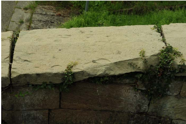
Abb. 10 Guter Zustand bis auf großen Ausbruch innenseitig Stein gelöst durch drückenden Bewuchs und Wurzelwerk
