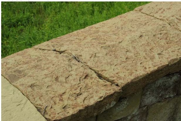
Abb. 14 Bruch des Abdeckers Beurteilung: Erhalt möglich, Kleben des Bruchs
