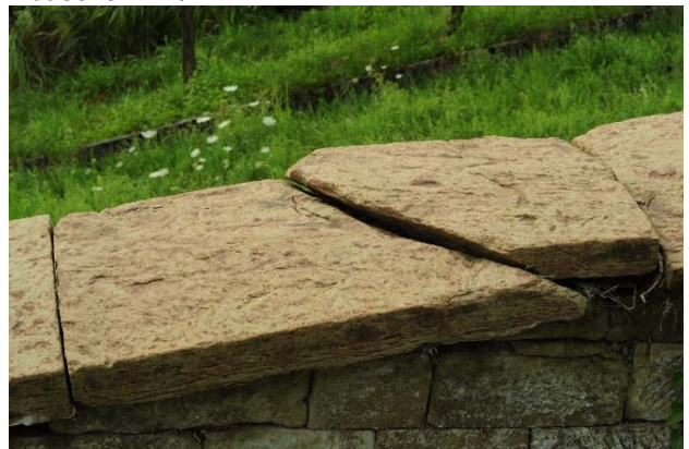
Abb. 15 Bruch des Abdeckers Beurteilung: Erhalt möglich, Kleben des Bruchs
