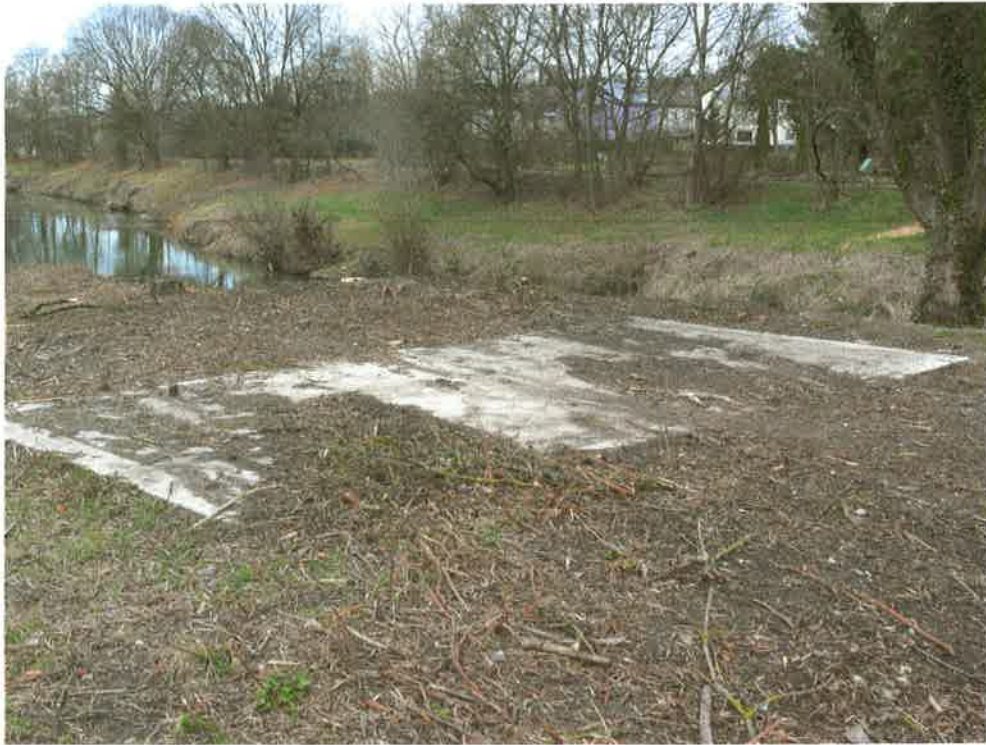
Bild 9: Betonplatte an der Birkelspitze (Aufnahme 08.03.2017)
