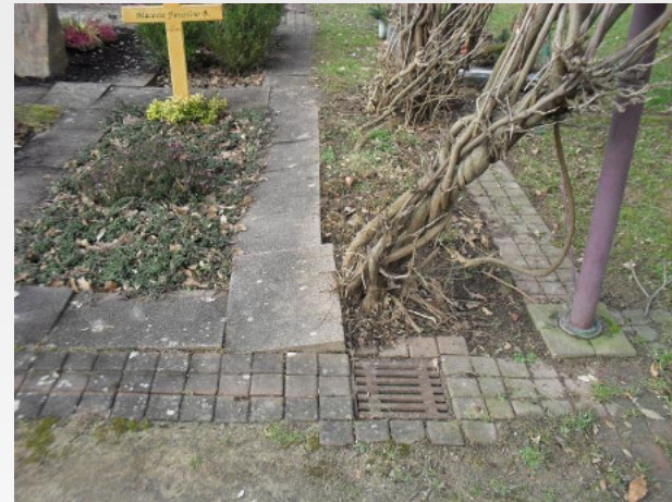
Plattenbeläge im Wurzelbereich
