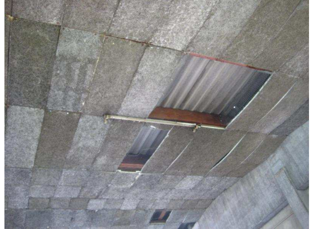
Abb. 10: Fehlende Deckenisolation in einigen der Lagerhallenbereiche
