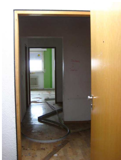
Abb. 8: Wohneinheiten in schlechtem Zustand
